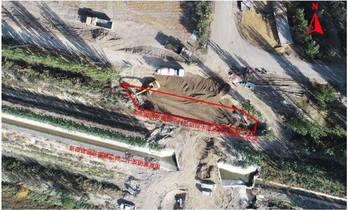
图 1 事故现场位置图（10 月 12 日复勘 无人机航拍）
