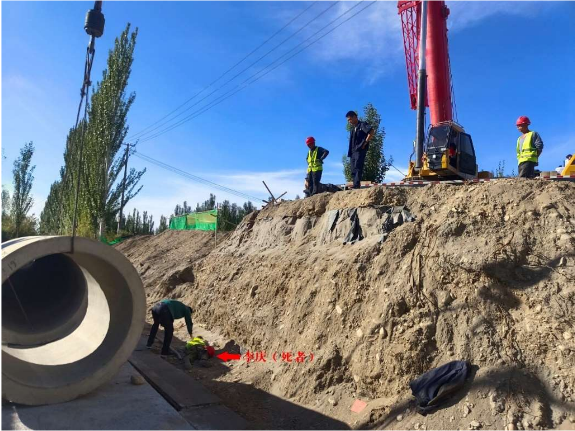
图 2 事故现场图片
